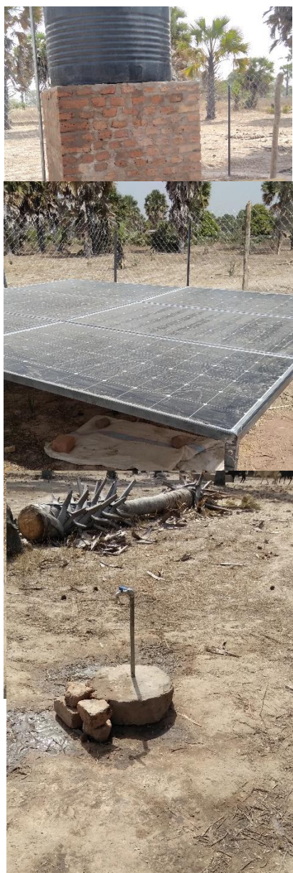
Système de distribution d'eau installé à Modé par Mbainaissem Haroune à Modé, Canton de Kimré, grâce au crédit du PADLFIT
