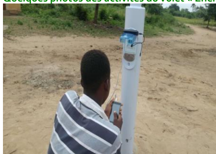
Un utilisateur chargeant son cellulaire à partir des lampadaires avec chargeur installés dans le cadre de la phase pilote
